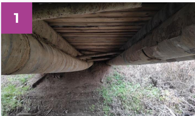
1 Смятие главных балок моста
