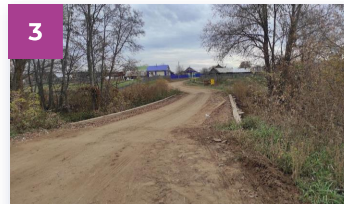
3 Габарит проезжей части не соответствует нормативным требованиям, отсутствие ограждений
