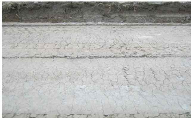
Усадочные трещины на основании
